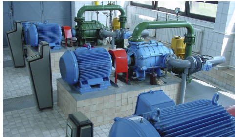
3.6. ábra. Soproni vízmű gépház (Forrás: sopviz.hu)
